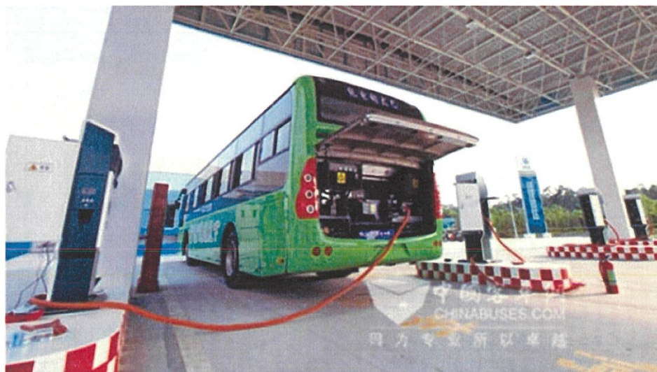
Figura 8. Sistem de incarcare a bateriilor autobuzului electric
